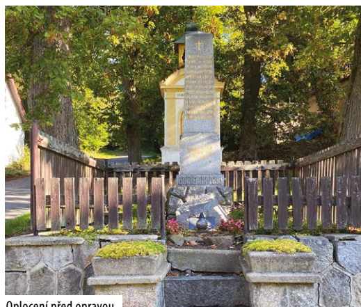
Oplotení před opravou
